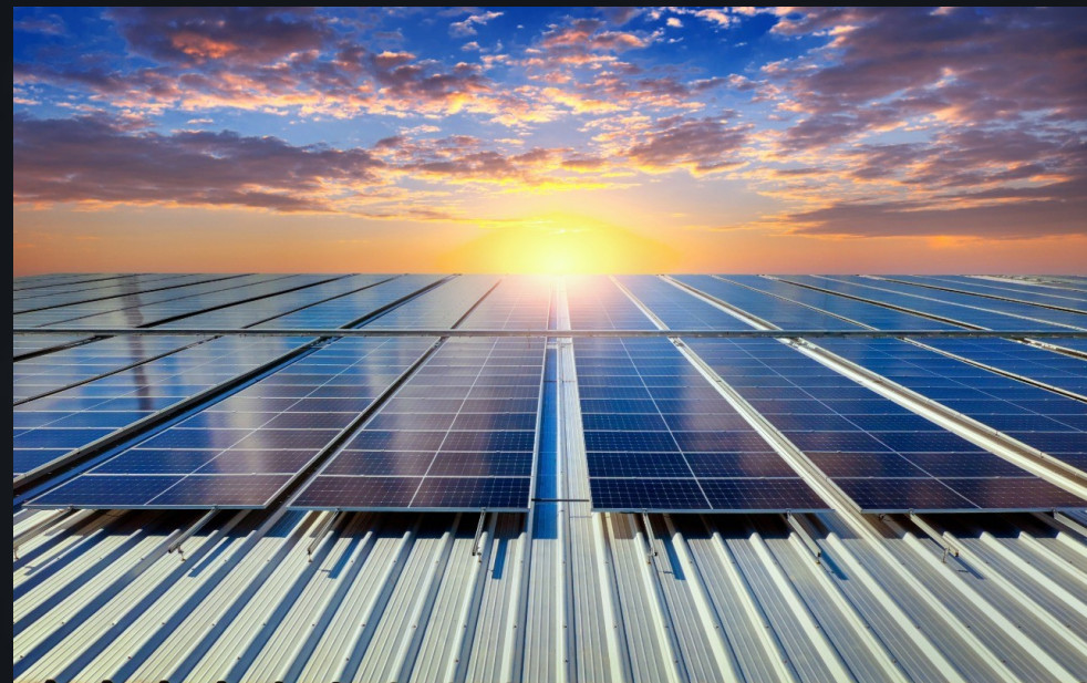
Planta fotovoltaica conectada a la red de distribución
